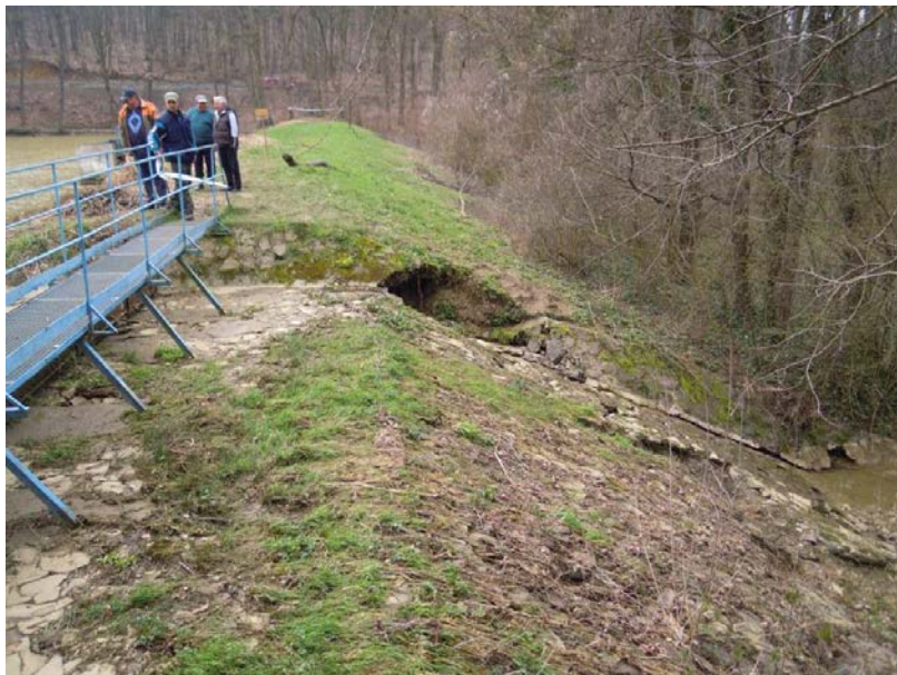
Völgyzárógát károsodásának helye
